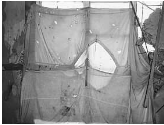
На снимке: жилой чердак, пододеяльник закрывает выбитый при артобстреле кусок здания . Район "7-й школы", Грозный, Чечня, 2004 г.
