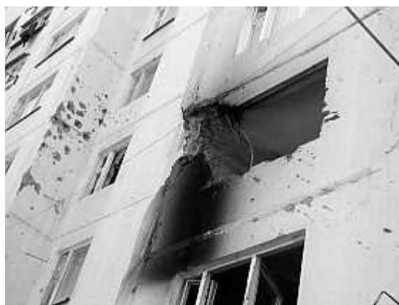
На снимке: следы артобстрела на фасаде многоэтажного дома. Район "7-й школы", Грозный, Чечня, 2004 г.
